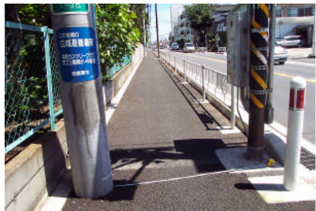
有効幅 1.45m ~ 1.5m のネック箇所多数 (歩道全幅 2.5m の有効性に甘え障害柱に対する観念たるみ)
